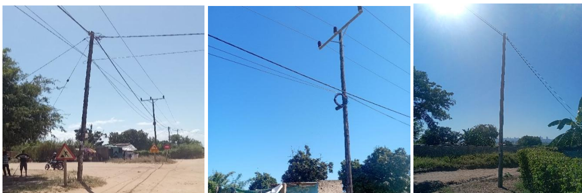
Figura 6-10 – Infra-estruturas públicas afectadas
