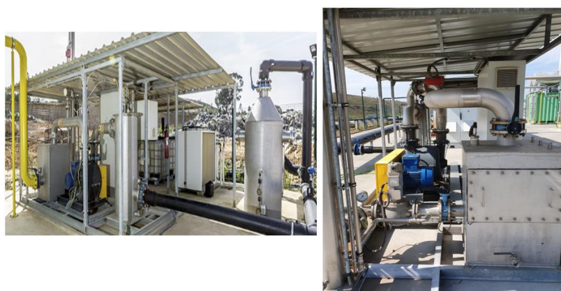
Figura 4-16 Exemplos de Pré-Tratamento e Estação de Regulação e Medição (ERM) para Biogás
