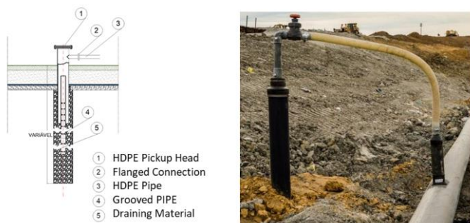
Figura 4-14 Recolha de biogás do aterro
