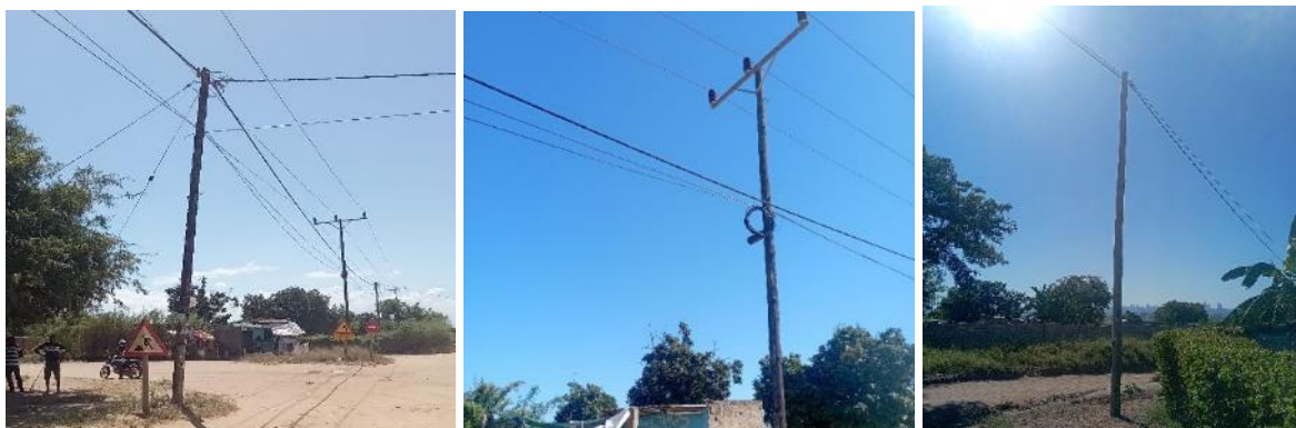
Figura 8-12 – Infra-estruturas públicas afectadas
