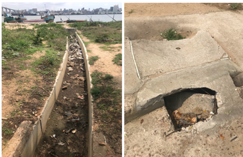
Imagem 17 – Vala e sarjeta existente próximo ao mercado e seu estado de conservação.
