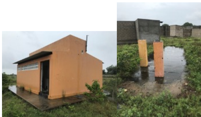
Imagem 42 – Sanitário público inoperacional no quarteirão 2 e Fossa séptica do sanitário.
