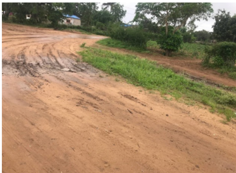
Imagem 24 – Ilustração dos focos de alagamentos ao longo das vias públicas.
