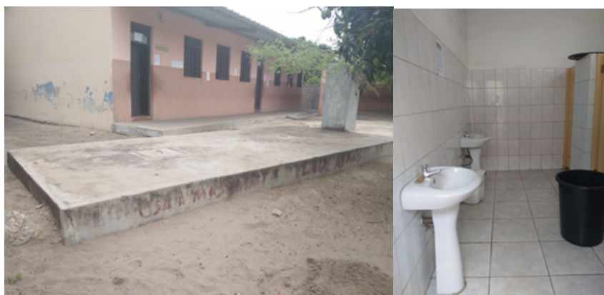
Imagem 36 – (a) Fossa séptica, e (b) lavatórios simples.
