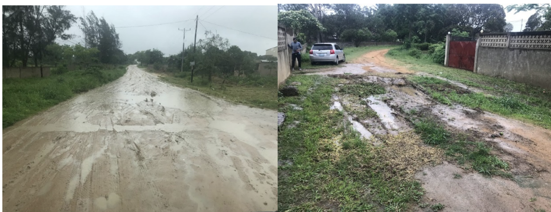
Imagem 27 – Focos de alagamentos ao longo das vias públicas.
