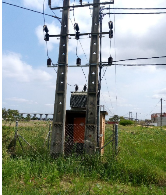
Imagem 83 – Posto de transformação de energia no bairro Guachene.
