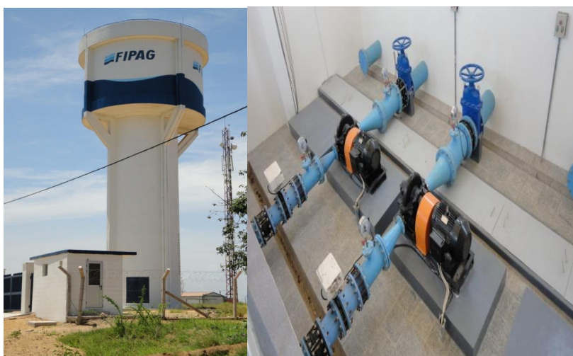
Imagem 32 – Reservatório elevado de 250m 3 e bombas que transportam água do reservatório semienterrado para o elevado.
