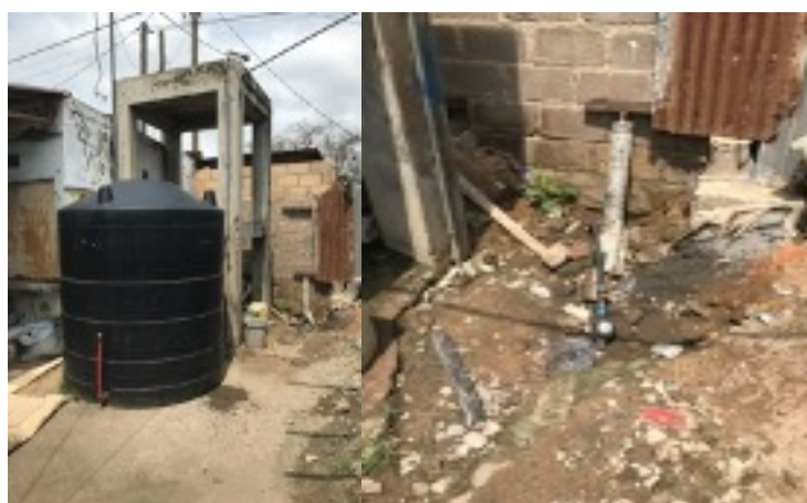
Imagem 48 – Tanque apoiado e o Hidrômetro (contador) em mau estado de conservação.
