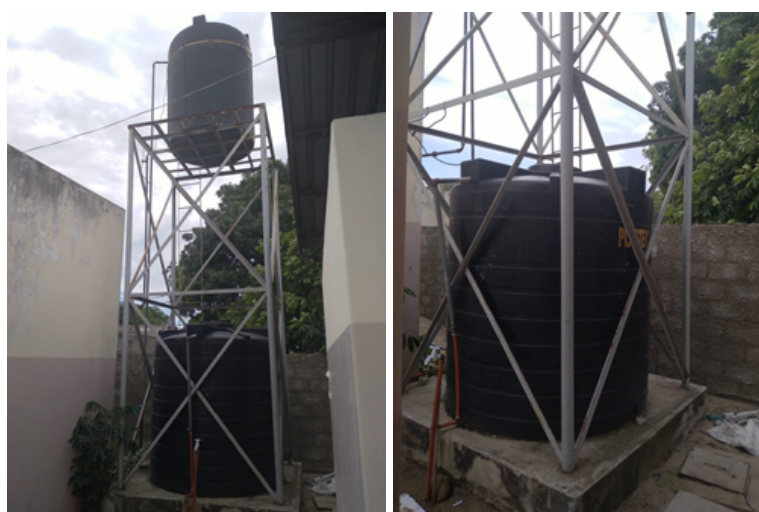
Imagem 35 – (a) Tanque elevado sobre a torre metálica, e (b) tanque apoiado sobre a base de betão.
