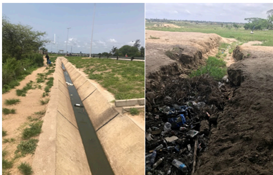
Imagem 18 – Vala ao longo da ponte Maputo – KaTembe e seu estado de conservação.
