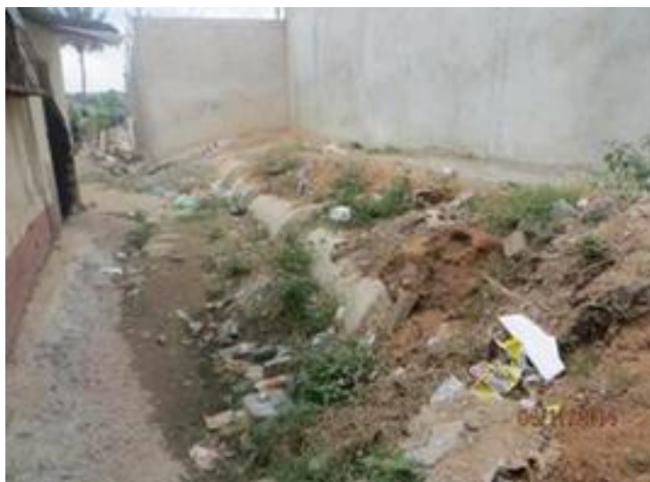
Imagem 9 - Tubo de esgoto na Rua da Agricultura (Bairro Jardim)
