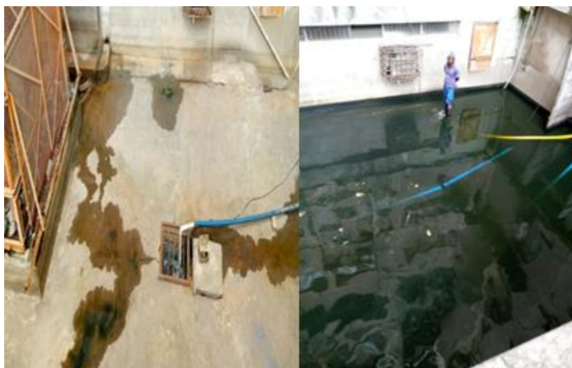
Imagem 12 - Problemas de limpeza e manutenção: antes e depois de um sistema de drenagem e saneamento de águas residuais de um edifício (Bairro Museu – Prédio Millano)
