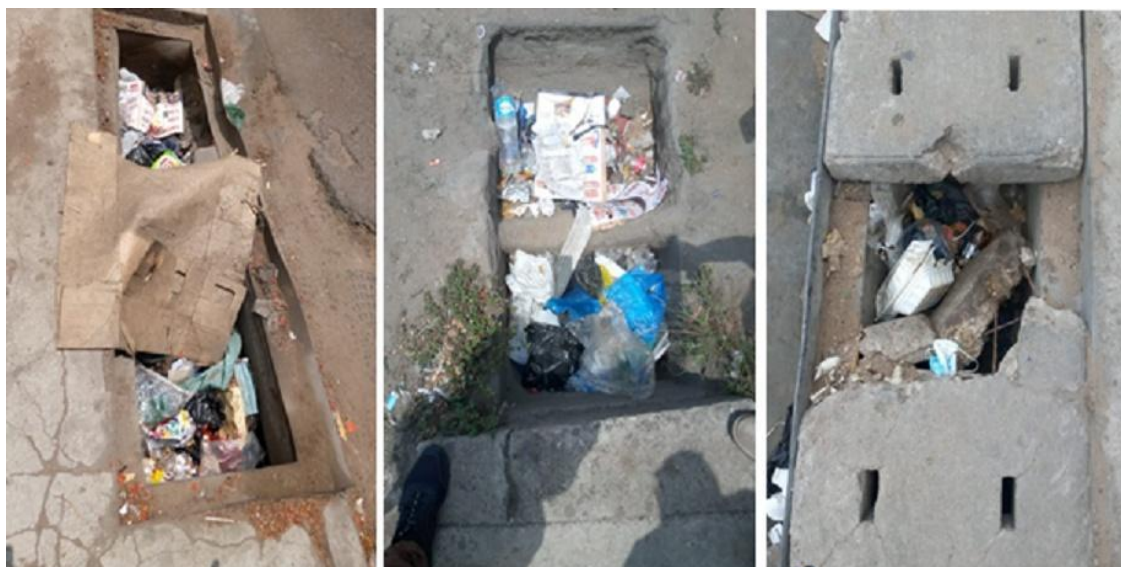
Imagem 10 - Resíduos sólidos depositados nos componentes de colecta do sistema de drenagem
