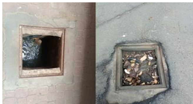
Imagem 14 - Caixas com tampa metálica vandalizada na Av. Ho Chi Min e caixas com tampa metálica vandalizada e assoreada na esquina com Av. Karl Max e 25 de Setembro
